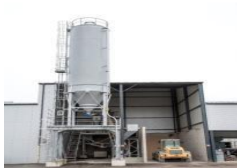
Stockage des matières premières
